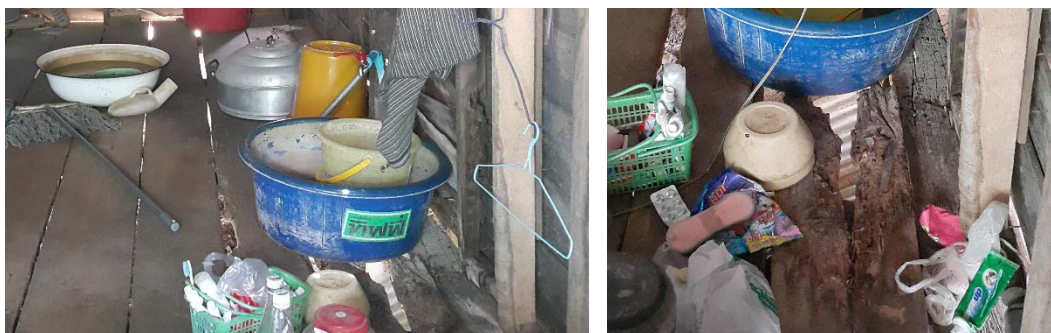
ภาพที่ ๔.๖ บริเวณที่อาบน้ำ แผ่นไม้พื้นผุเป็นรูกว้าง
