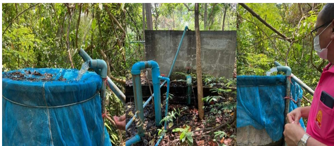
ภาพ ๔.๔ ระบบประปาภูเขาบ้านธารมะยม
