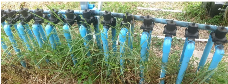
ภาพที่ 4.6 พัฒนาพื้นที่เรื่องควบคุมระบบจ่ายน้ำอัตโนมัติเป็นที่ศึกษาดูงาน ที่มา : คณะผู้วิจัย
